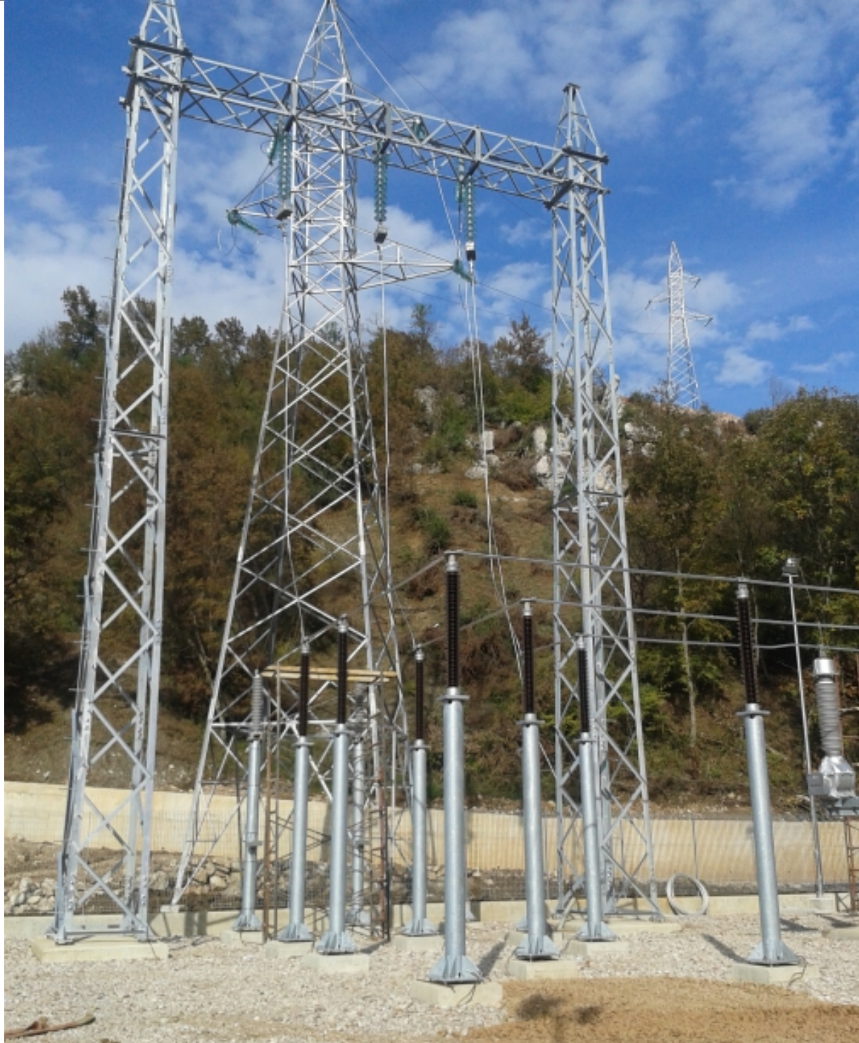
■ Portal Nënstacion-linje 110 KV
